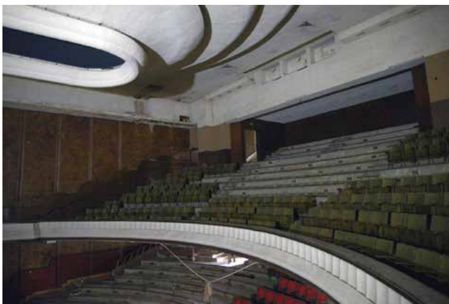
Seconda Galleria Odeon. Stato di fatto attuale: sopra lo spazio di seduta al centro c'è la sala di proiezione cinematografica (le tre finestre di cemento in alto)
